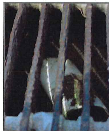
Descarga ilegal en la Calle La Paz
